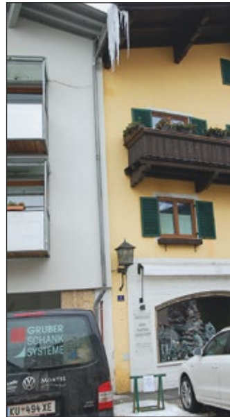
Eiszapfen stellen eine große Gefahr für Passanten dar.
