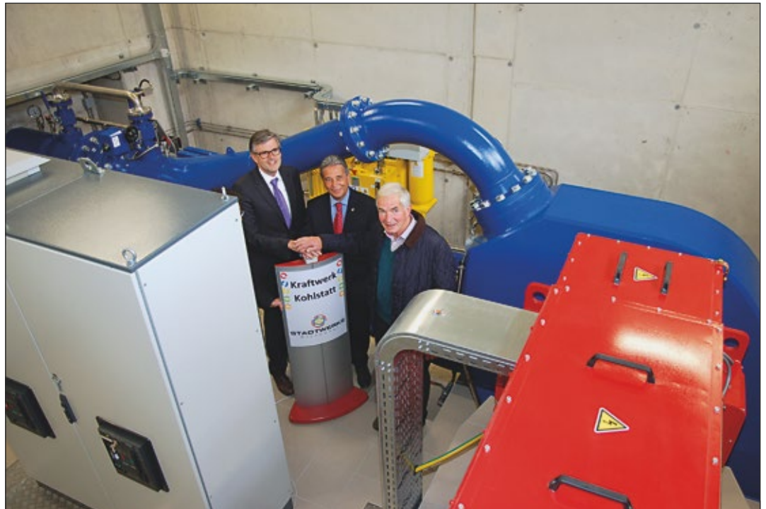
Das Kraftwerk Ehrenbach – Kohlstatt liefert seit Herbst 2015 umweltfreundlichen Ökostrom.
