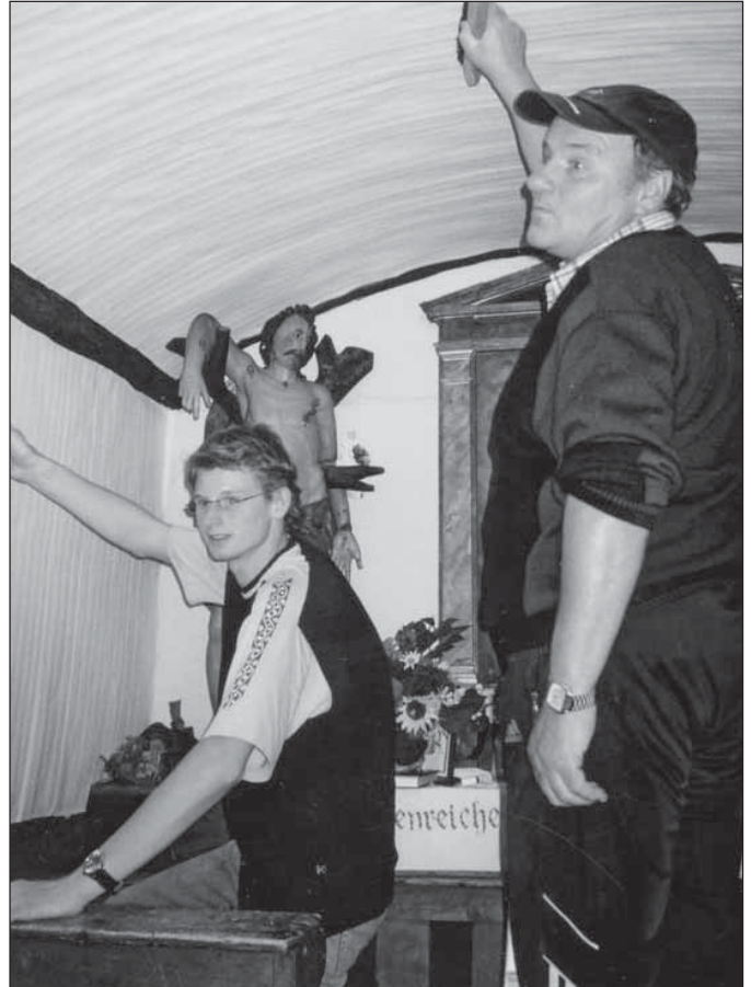
Sache an. Nach Anbringung einer Isolierung wurden die Tapeten erneuert, „Buwei“ Messenlechner ist als gelernter Tapezierer vom Fach. Auch die zahlreichen Andenkenbildchen wurden in Ordnung gebracht und teilweise neu gerahmt. Den beiden ständigen Besuchern des Ehrenbachkirchls gebührt ein Dank für gelebte Ehrenamtlichkeit.
