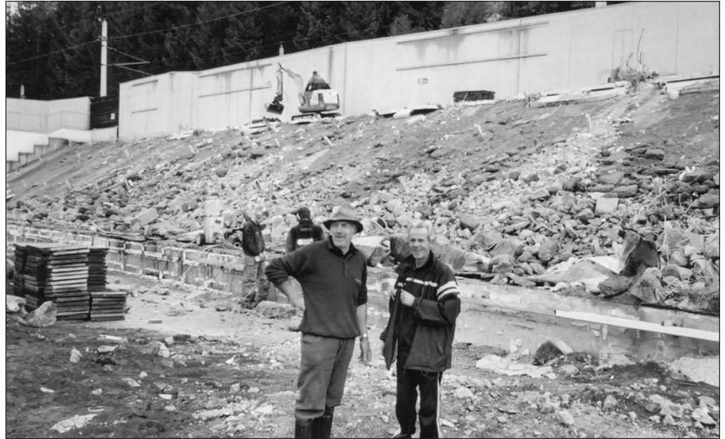
Mit der Bauverhandlung begannen auch die Bauarbeiten, bereits am ersten Tag wurden die Beton-elemente der Ostribüne am Tennisplatz abgetragen. Der Schnappschuss zeigt Platzwart Fritz Mitteregger (rechts) im Gespräch mit Kitzbühel-Original Rudi Feiersinger, der bei solchen Anlässen gern als Gegenpol zur heutigen Wegwerfgesellschaft tätig ist.
