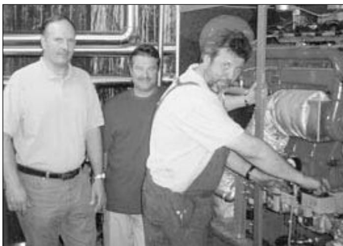
Findig-technische Mitarbeiter in der Kläranlage, Andreas Engl (links) und Josef Steiner (rechts) bei der Inbetriebnahme des neuen Blockheizkraftwerks, in der Mitte Betriebsleiter Ing. Walter Hinterholzer.
