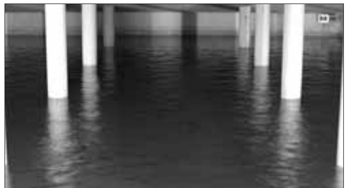
Der Hochbehälter am Sonnberg fasst mehr als 6.000 m 3 Wasser.
