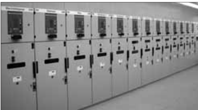
Die Schaltstation Süd/Höglrainmühle
