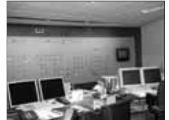
Die Schaltwarte bei den Stadtwerken
