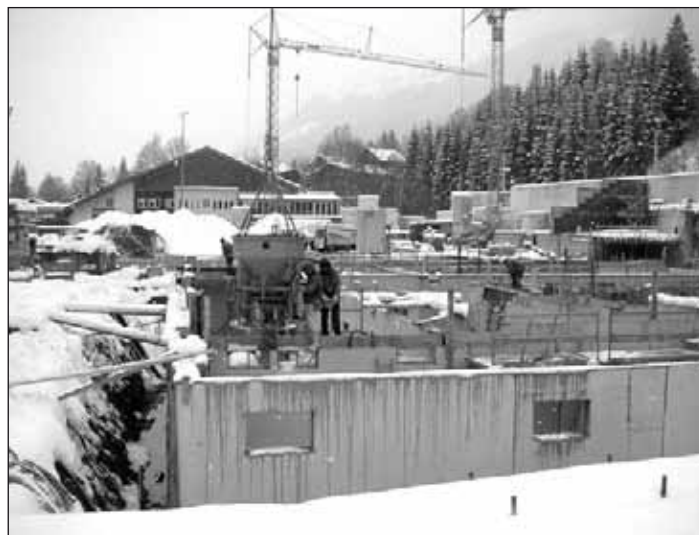
Die neue Anlage wächst sichtbar, die Erschwernisse durch den frühen Wintereinbruch für die am Bau Beschäftigten waren schon sehr groß
