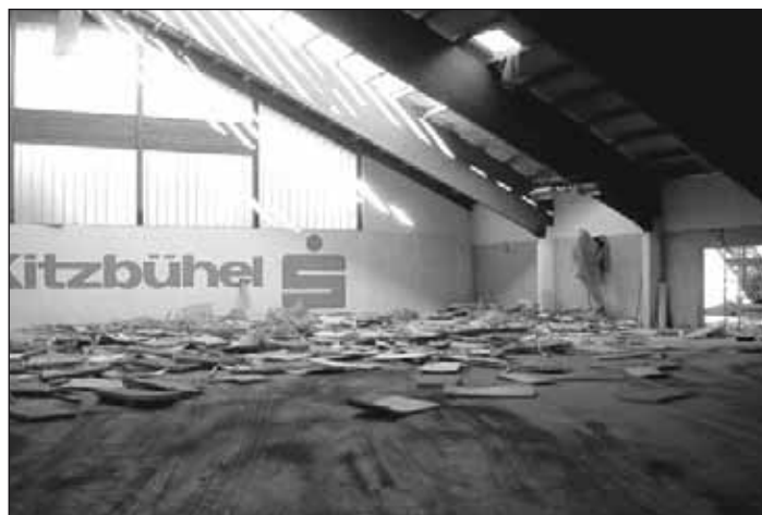
Dieses im Zuge von Teilabbrucharbeiten an der Tennishalle geknipste Foto veranschaulicht den Umfang der Sanierungsarbeiten am Dach und Boden, die Halle ist zwischenzeitig renoviert und bespielbar.
