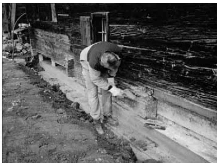
Hier zeigt sich die im Text erwähnte Vermorschung der Westseite, eine Fundamentierung und Austausch schadhafter Holzblockteile sind notwendig.
